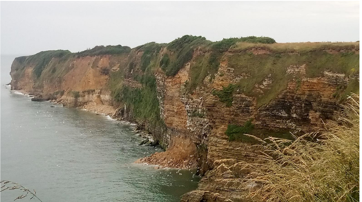
L'effondrement de la falaise (Photographie Régis Purenne)
